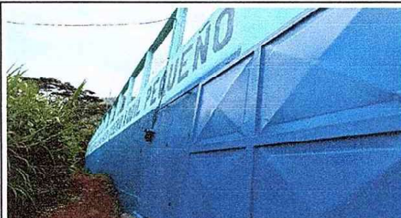
Foto 6: Se observa el remozamiento en el muro de contención y perimetral exterior, así mismo el remozamiento en el portón de acceso principal.
